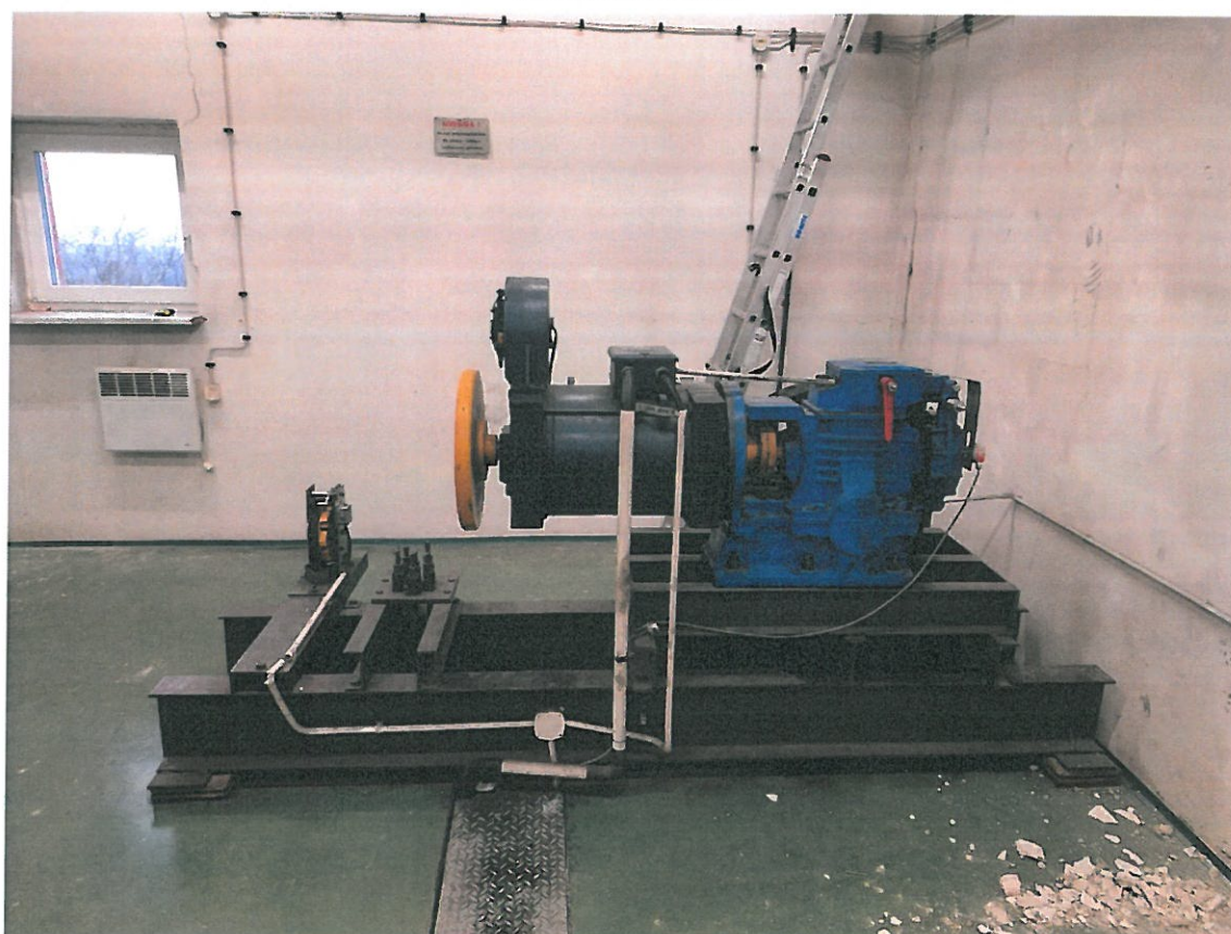
Fot. 6. Maszynownia dźwigu – widok nr 1
